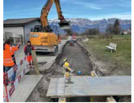
Wassertransportleitung im Neufeldweg.
