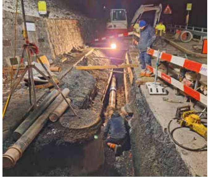
Auch Einsätze in der Nacht gehören zum Arbeitsalltag der Mitarbeiter im Wasserwerk.
