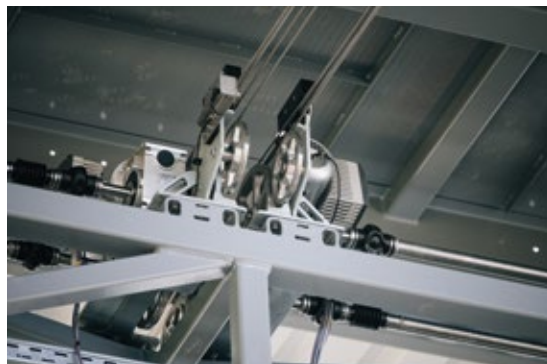
Je nach Wetterlage kann das Solarfaltdach ein- und ausgefahren werden.
