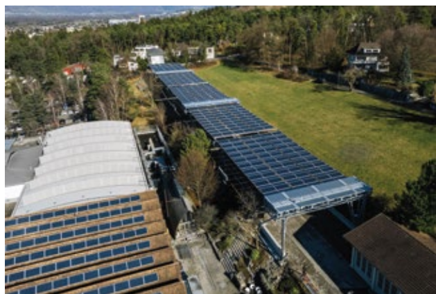
600 Solarmodule erzeugen nachhaltige Energie.
